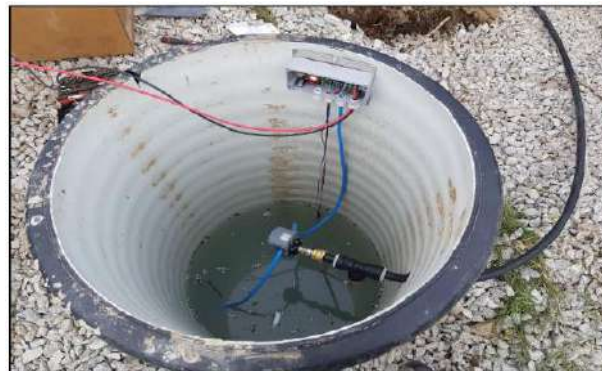
Puisard et pompe de relevage
